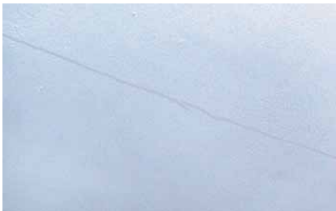
Фото 76. Штукатурный потолок в кухне квартиры. Сделан четыре года назад без армирования рустов стеклохолстом (уложена только серпянка). Трещины вышли на поверхность потолка в первый же год эксплуатации
