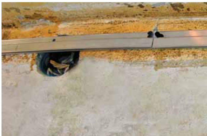
Фото 96. Пример попадания багета на распаячную коробку. В данном случае доступ к проводам в коробке затруднен, но возможен. Размещение багета выше коробки не получилось, там расположена скрытая электропроводка. Еще выше не позволяет кривизна базового потолка
