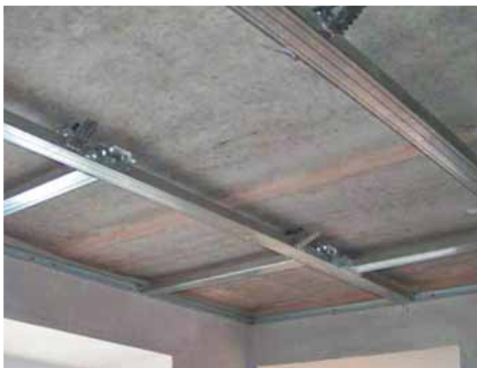
Фото 86. Вспомогательные профили каркаса установлены только под стыками гипсокартонных листов
