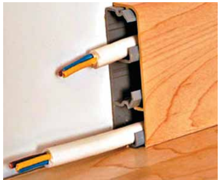
Фото 49. Монтажный короб с кабель-каналом
