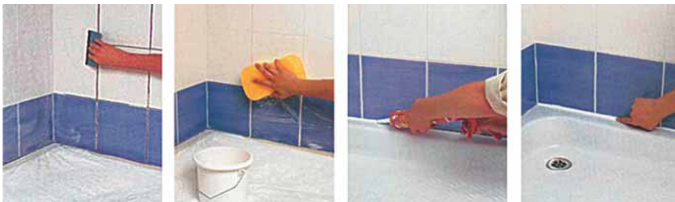
Фото 69. Затирка швов облицовки и покрытие силиконом шва между душевым поддоном и облицовкой
